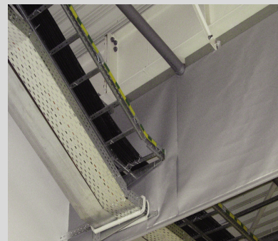
Przejście instalacyjne przez stałą kurtynę dymową
