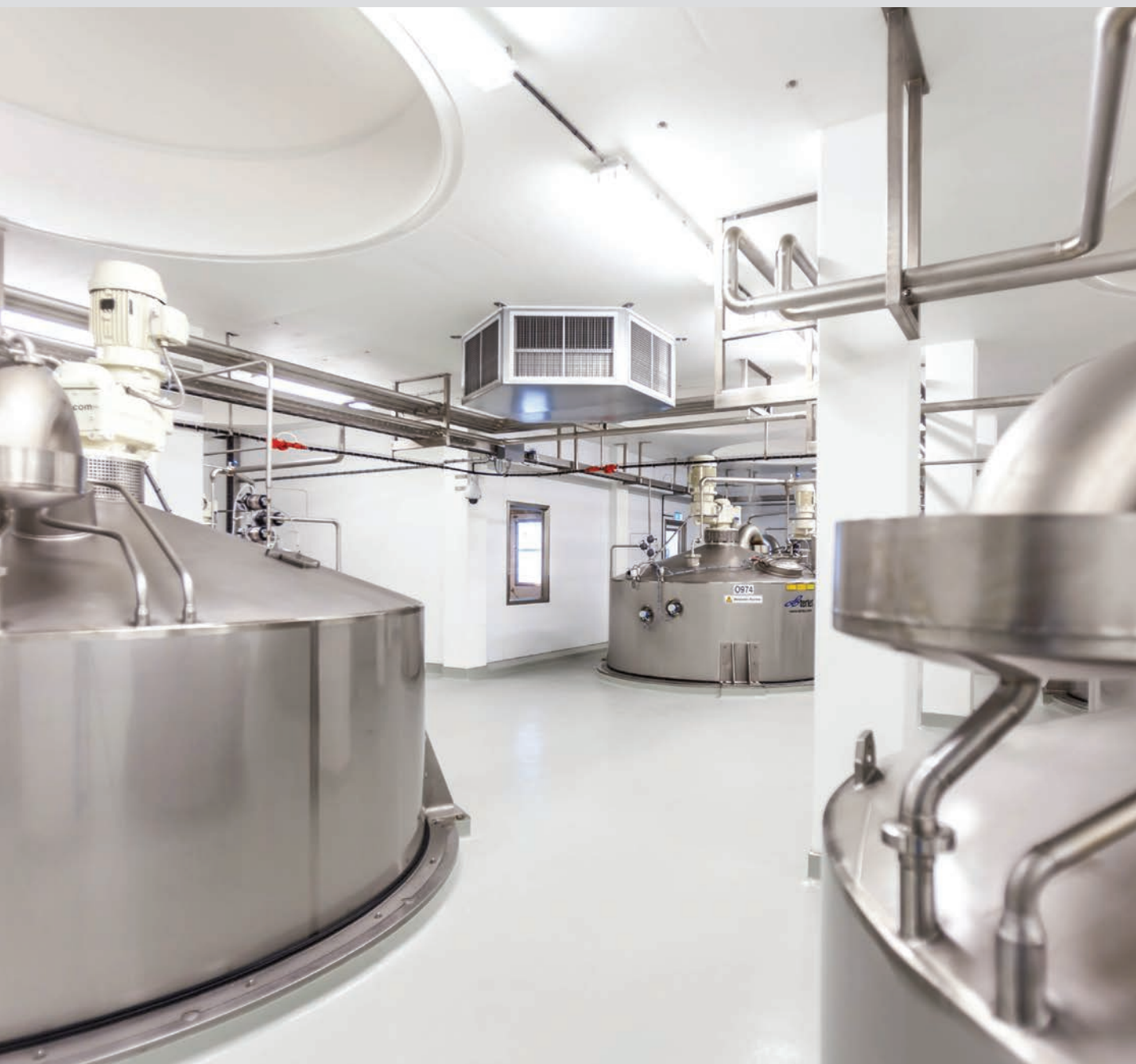
DMV Veghel, Holandia - System chłodzenia adiabatyicznego Colt Coolstream
